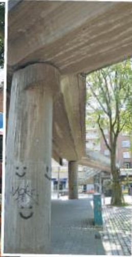
Die Fußgängerbrücke über die Billstedter Hauptstraße finden viele hässlich
